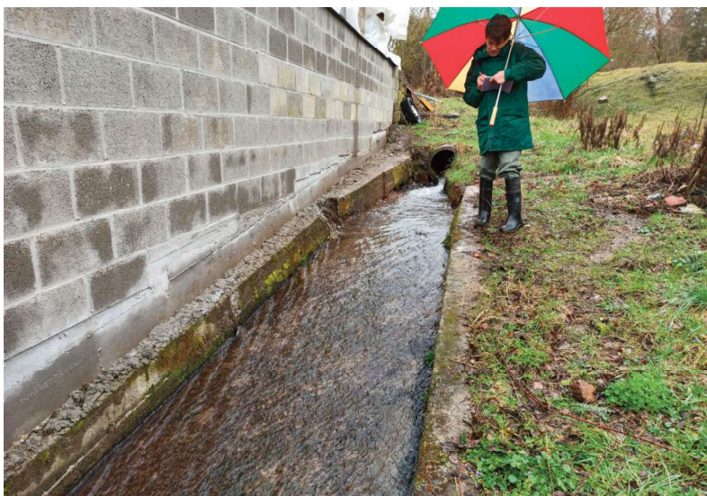
Fig. 13. Le ru en amont du chantoir du Moulin est canalisé empêchant les eaux de s'infiltrer dans les calcaires givetiens pour rejoindre l'aquifère de la Vilaine Source
