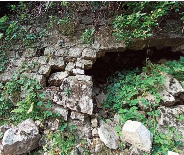
Mur de soutènement de la route en partie effondré par le soutirage provoqué par la résurgence.
