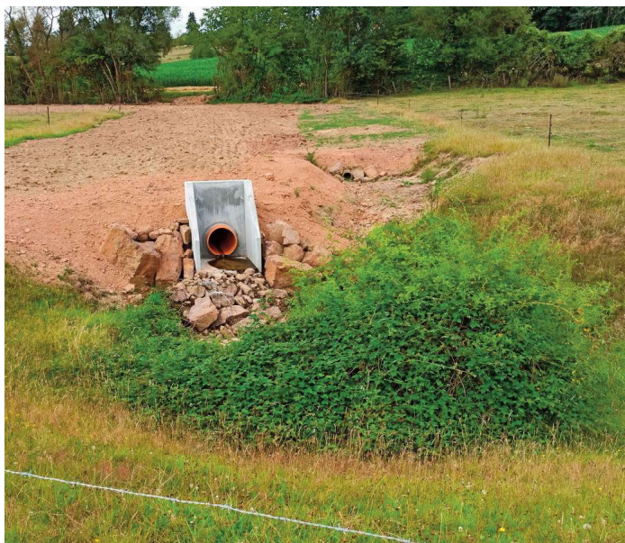
Fig. 12. Canalisation récupérant les eaux de ruissellement, pour les renvoyer vers le chantoir aval et une infiltration hors zone urbanisée.
