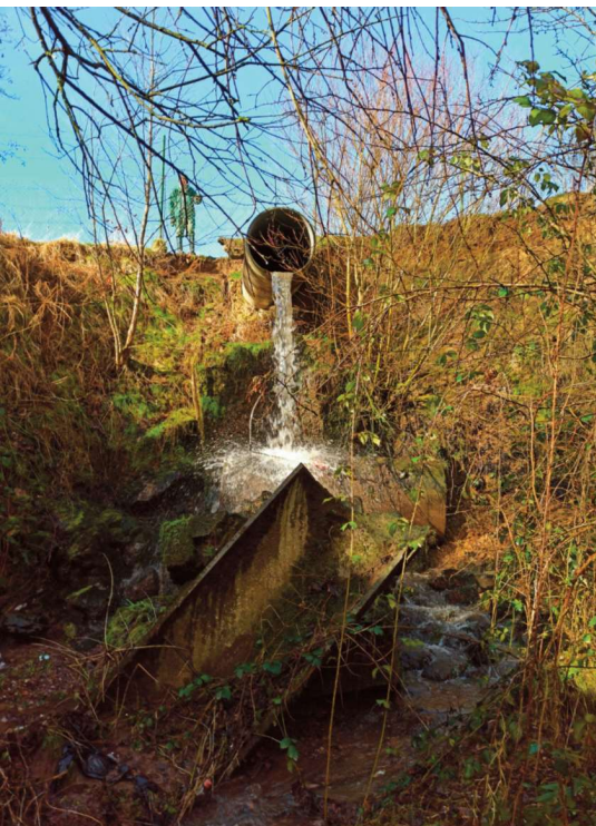
Fig. 6 Les eaux de ruissellement et de voirie canalisées et amenées jusqu'au Trou du Taureau (point C), où elles s'infiltrent dans le sous-sol . .
