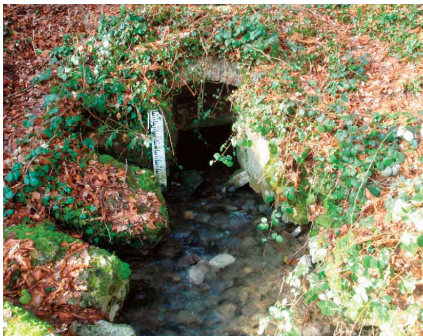
Fig 1. Même à l'étiage (comme ici en nov. 2019) et alors que la plupart des chantoirs sont à sec, le débit de la Vilaine Source reste soutenu grâce à la percolation lente qui alimente ce drain
