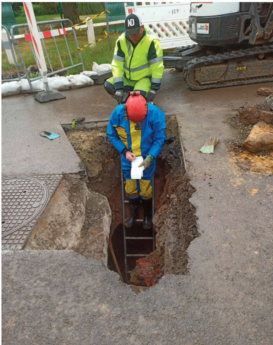
Fig. 10. Exploration et levé topographique de l'effondrement dans la rue Bertulot le 5 juin 2020.
