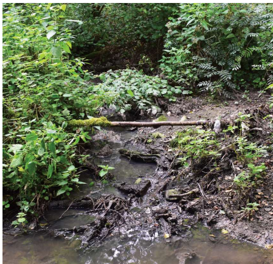
Fig 4. Arrivée de l'égout de Falmagne, se déversant dans le ruisseau à l'entrée du village de Falmignoul
