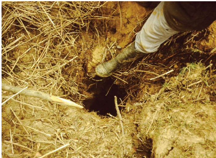
Fig 2. Petit affaissement avec point d'infiltration des eaux découvert en 1994 dans le vallon sec (photo JP Liegeois).
