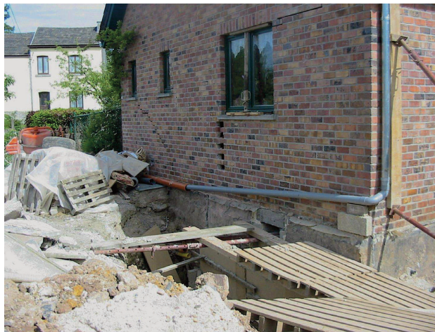
Photo 4. Dislocation d'une maison du village, probablement construite sur un vide karstique (photo J.-C. Schyns, 2005).
