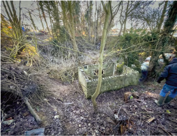
Photo 7. La doline de la chantoire de Soy est fortement encombrée de débris. Il y subsiste toujours la ruine du local à matériel de l'ESB qui y a effectué de gros travaux de désobstruction dans les années 60.
