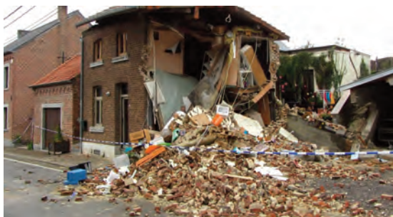
Fig. 6. La maison n° 120 rue du Baron d'Obin ruinée et ensuite abbatue suite à l'effondrement (photo SPW).
