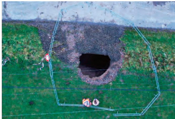
Fig. 18. Les Isnes, vue de l'effondrement. La canalisation est en bordure en haut du trou (photo Ville de Gembloux).
