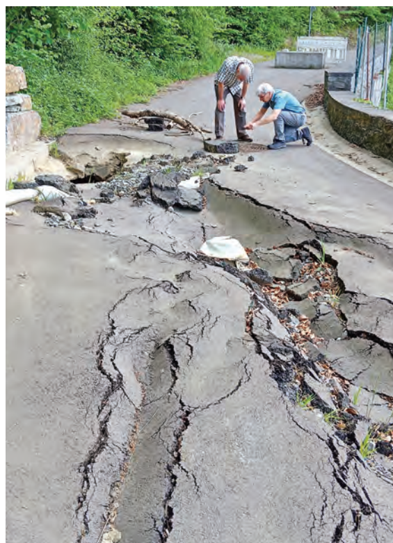
Photo 1. Les apports massifs d'eau souterraine en amont de la résurgence de Ny (notamment liés à ces chantoires) ont provoqué le soulèvement et ensuite l'effondrement de la route (photo cwepss, mai 2025).
